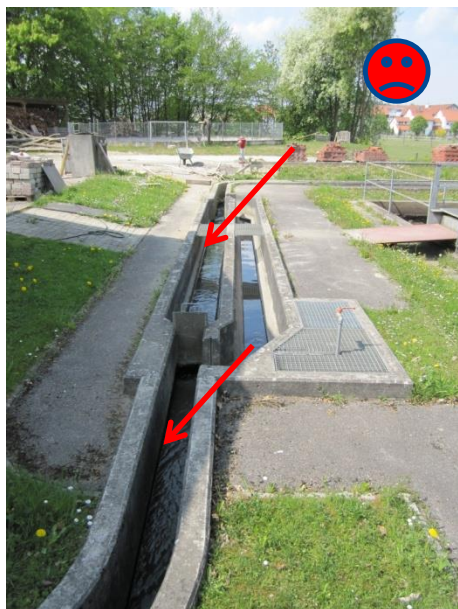
Bild 2.1 Verkehrsweg führt über ungesichertes Gerinne
