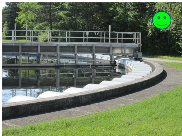
Bild 3.55 Nachklärbecken mit Abdeckung
