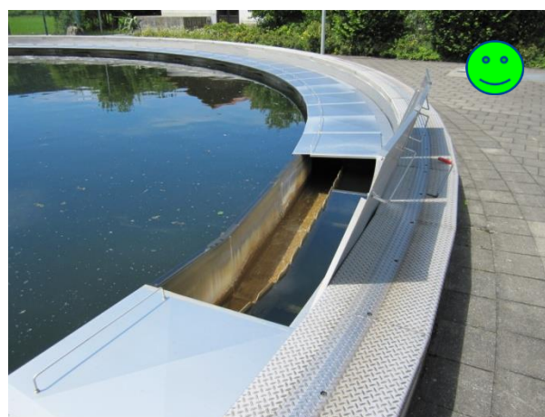
Bild 3.52 zu Wartungszwecken geöffnete Abdeckung
