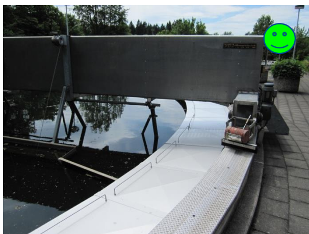
Bild 3.51 Nachklärbecken mit Abdeckung
