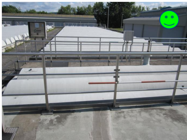
Bild 3.8 komplett abgedecktes Belebungsbecken (Abdeckung ist begehbar)
