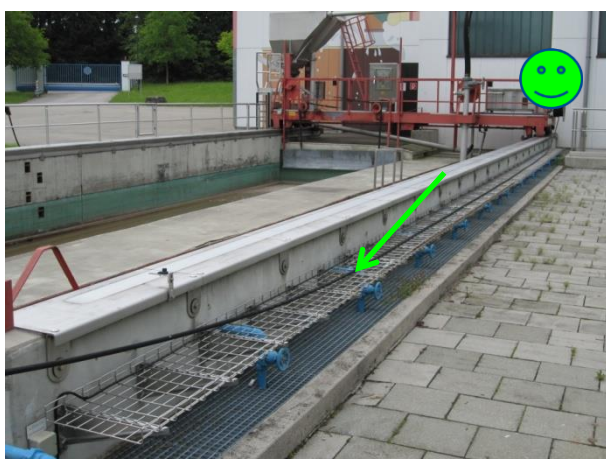
Bild 3.41 Gitter als Kabelführung
