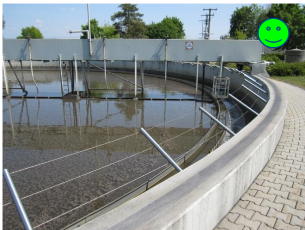
Bild 3.59 Nachklärbecken mit Stahlseilen (Räumer)
