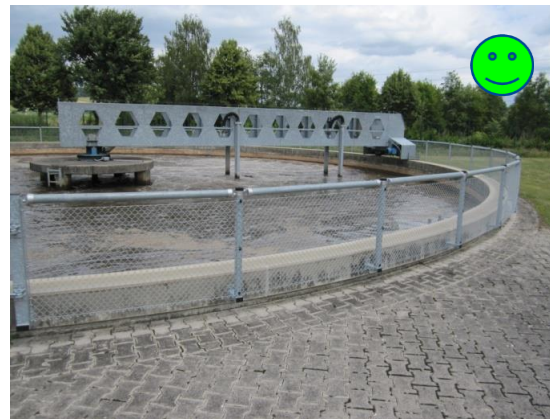
Bild 3.46 Belebungsbecken mit Räumerver
