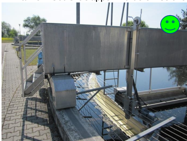
Bild 3.57 Edelstahlseile als Auffangvorrichtung
