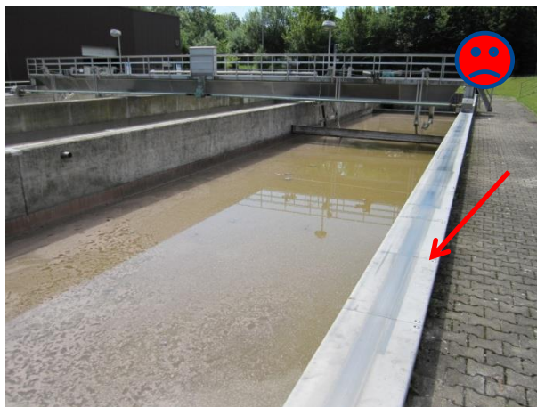
Bild 2.2 Verkehrsweg führt an ungesichertem Sandfangbecken vorbei
