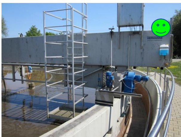
Bild 3.69 Arbeitsbühne am Räumern
