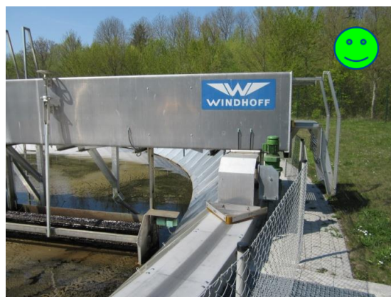
Bild 3.44 Räumerver mit Überstieg
