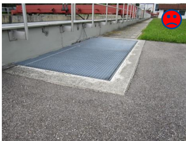
Bild 3.4 Gitterrost im Verkehrsweg ohne erkennbare höchstzulässige Belastung
