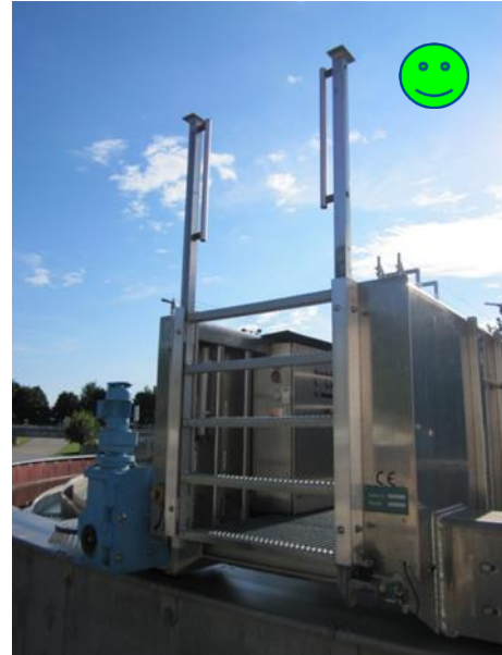
Bild 3.66 schiebbarer Aufstieg zur Räumbrücke
