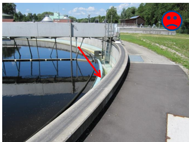
Bild 3.50 Nachklärbecken ohne Absturzsicherung
