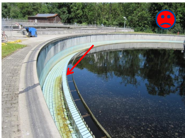
Bild 3.49 Nachklärbecken ohne Absturzsicherung
