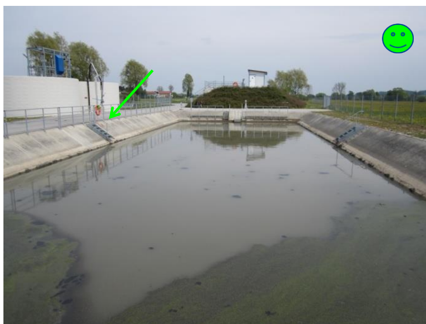
Bild 3.3 Absetzbecken mit Geländer an Grenze zu Verkehrsbereich (Wassertiefe < 1,35 m)
