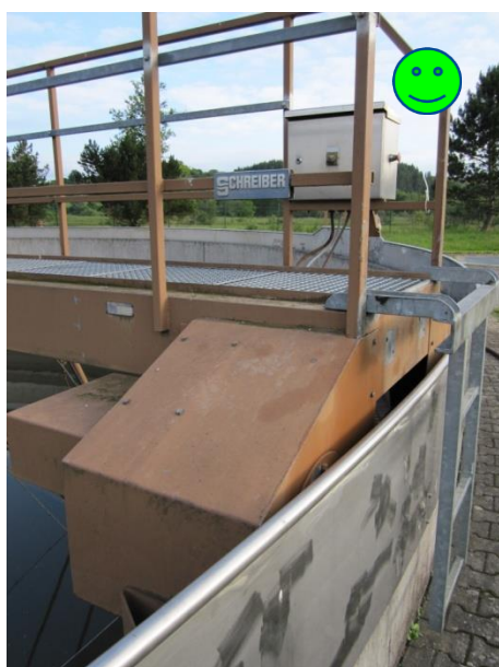
Bild 3.63 abgedecktes Laufrad / Aufstieg zum Räumern
